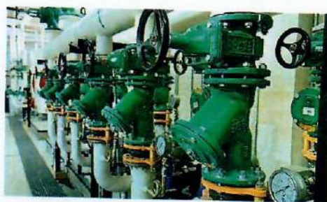
تاسیسات صنعتی کارخانه فولاد الیازی یزد
